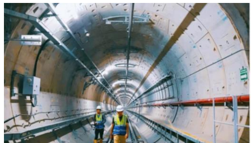
Sarana Jaringan Utilitas Terpadu
